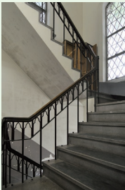
図1: 支柱が1本おきに切断された手摺
