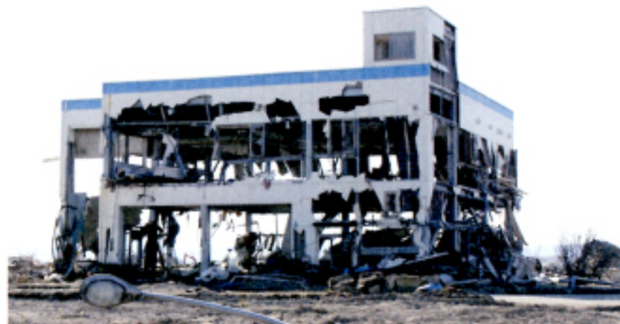
東北学院関上シーサイドハウスの被災状況
