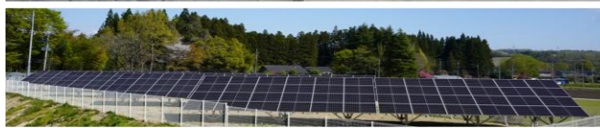
エコロジーセンター愛子外観及び太陽光発電設備
